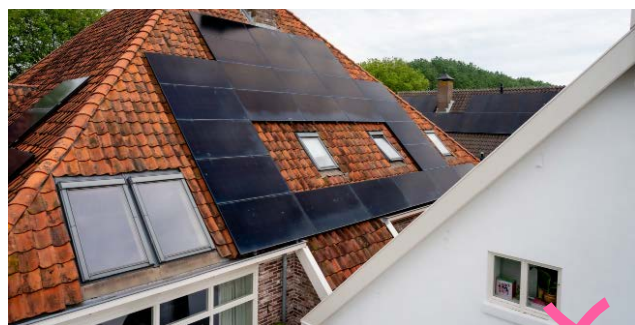
panelen vormen geen aaneengesloten vlakken
